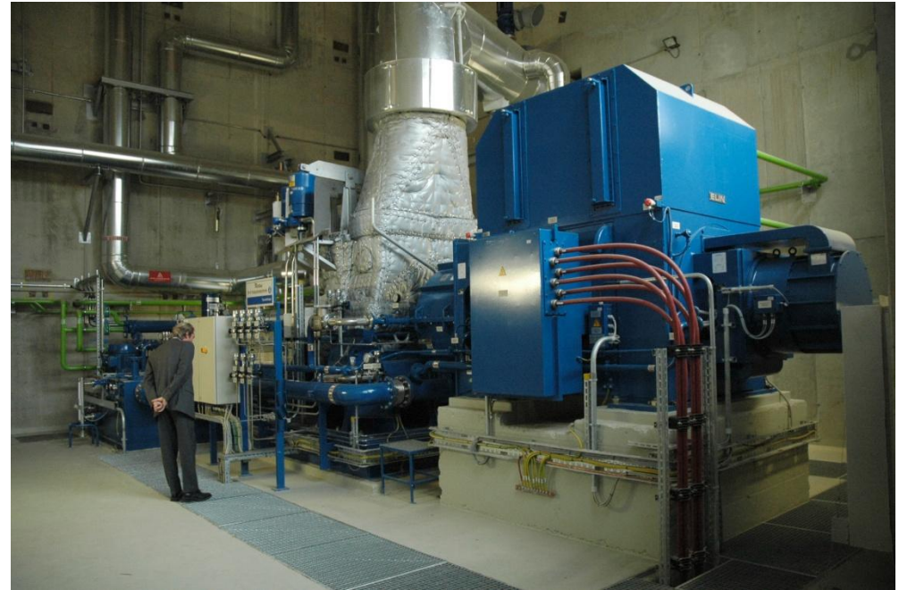
Fig. 24. Caldera de Biomasa. [ Fuente ]
