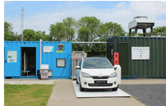
Fig. 20. Recarga de Biogás. [ Fuente ]
