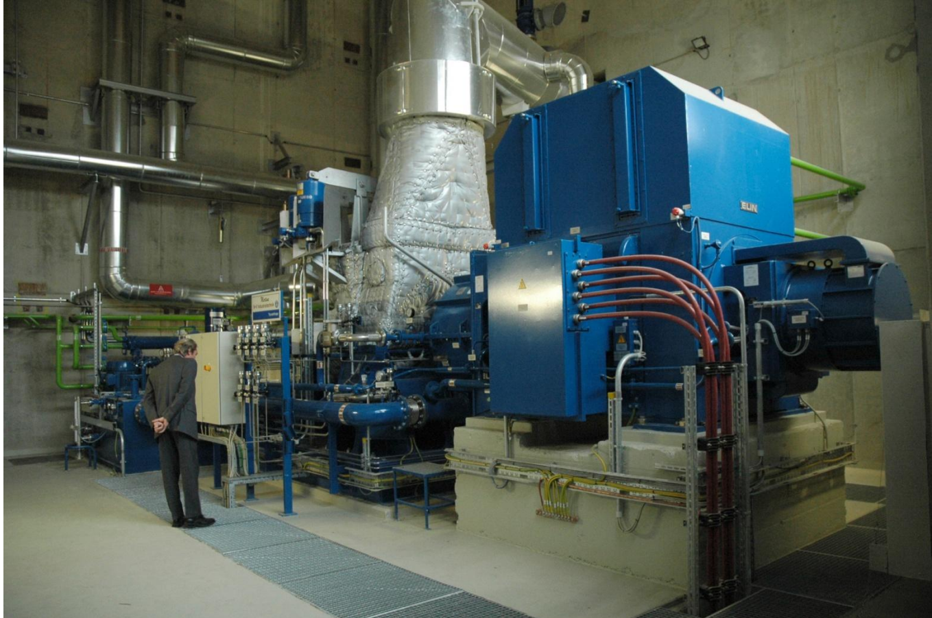
Fig. 22. Caldera de Biomasa. [ Fuente ] wikipedia
