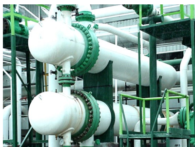
Intercambiadores de Calor
