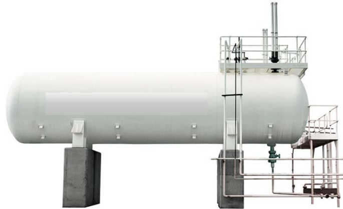
Figura 3.14. Tanque aéreo cilíndrico horizontal. Adaptación de la fotografía publicada por Nolundi Rawana en Wikimedia bajo licencia CC BY-SA 3.0 [12]
