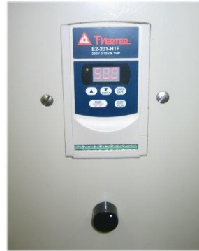
Figura 3: Inversor de frecuencia (5).
